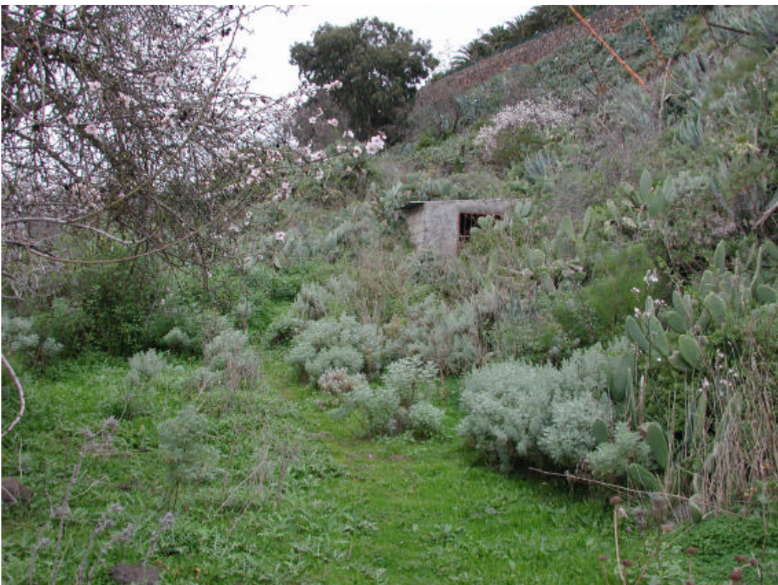
Figura 8. Caseta con bomba hidráulica
