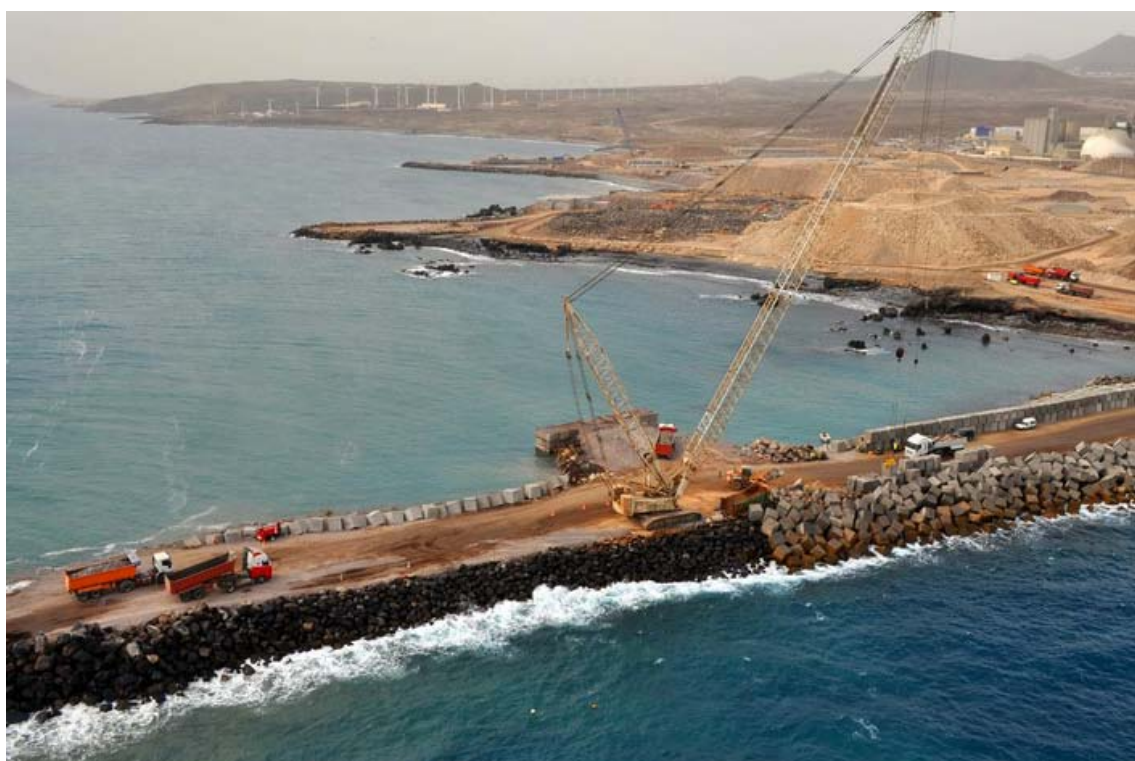
Figura 10. Aspecto general de las obras en febrero 2012. Foto cedida por A. Márquez.
