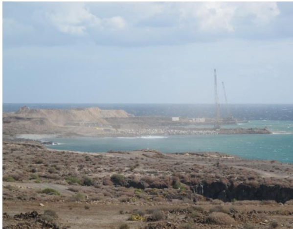
Figura 19. Nube de polvo generada por las obras un día normal de viento (14/2/2012)
