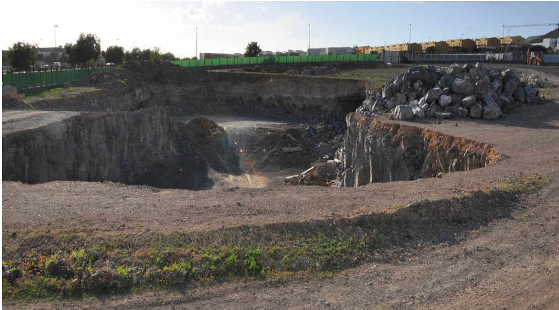
Movimientos de tierra para plantación de vegetación en Las Chafiras. Actuación incorrecta.
