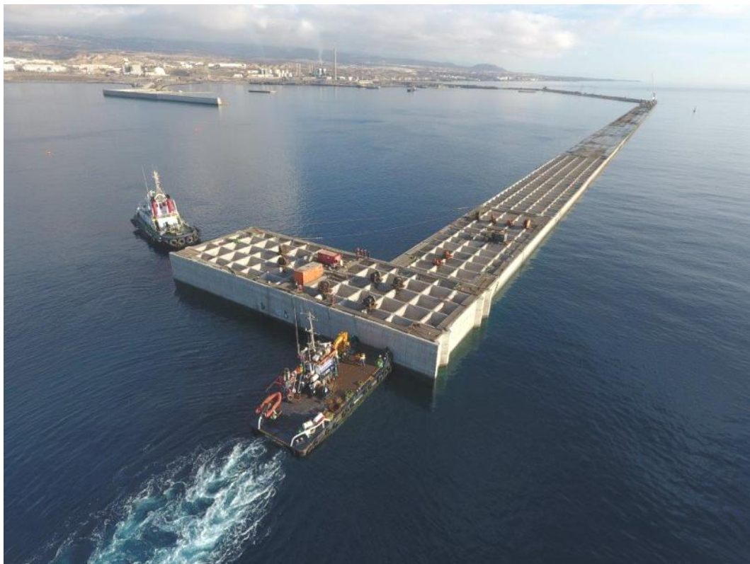
Figura 7. Colocación de los cajones del martillo del dique exterior del puerto de Granadilla (Foto Autoridad Portuaria, octubre 2016)
